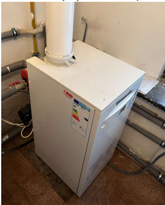
Obrázek č. 2.6.12: Plynový kondenzační kotel Junkers
