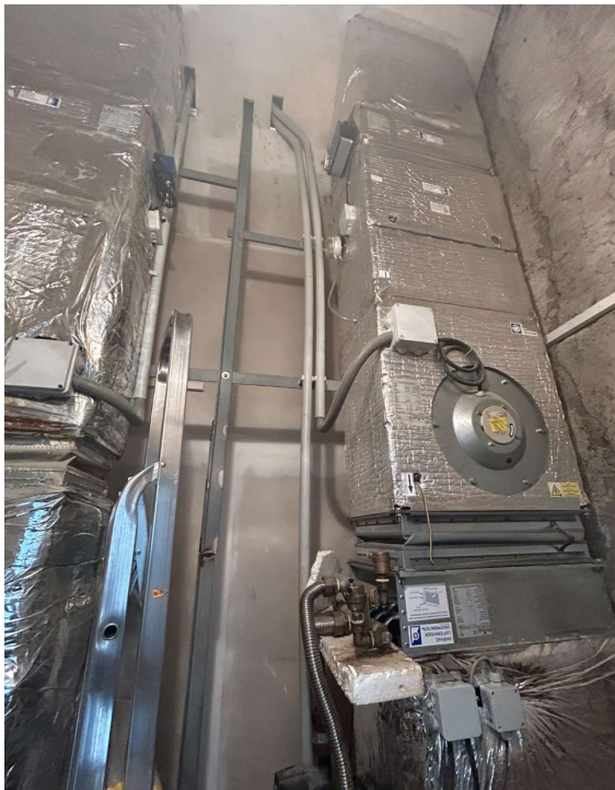
Obrázek č. 2.6.9: Vzduchotechnika
