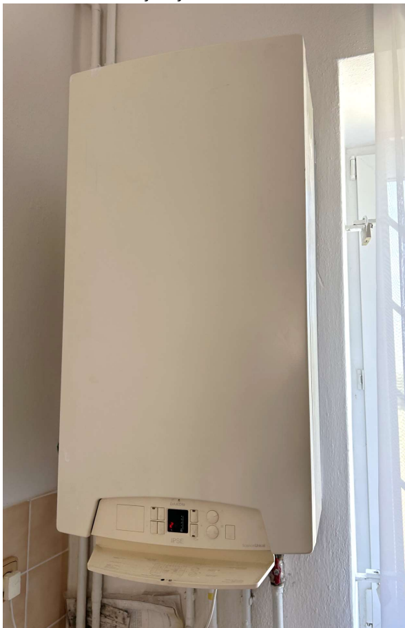
Obrázek č. 2.6.35: Plynový kotel Dakon
