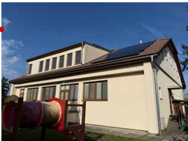
Pohled na fotovoltaické panely, další jsou instalovány na střechu nad horními okny.
